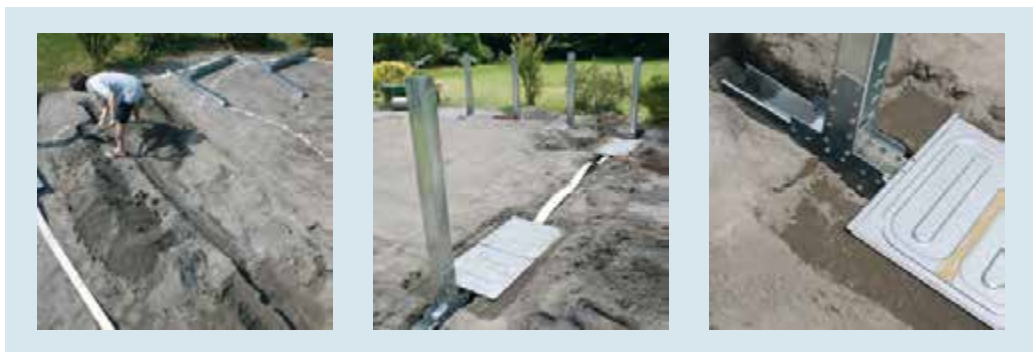
Sistema de omegas Omega system Renforts enterrés Sistema omega
